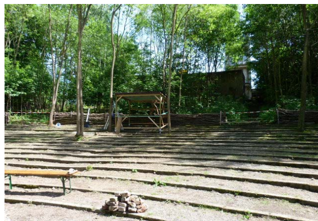
Der Urwald wurde beseitigt – die Traversen freigelegt
